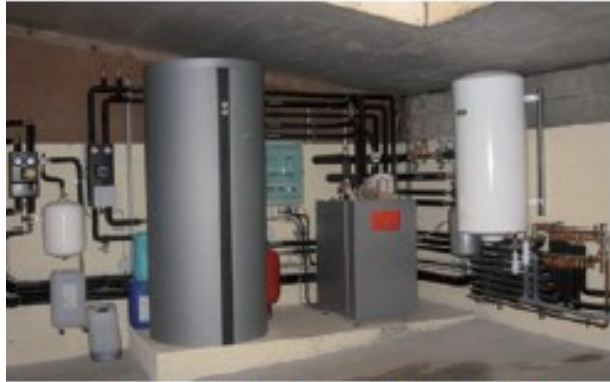
Local technique avec pompe à chaleur
